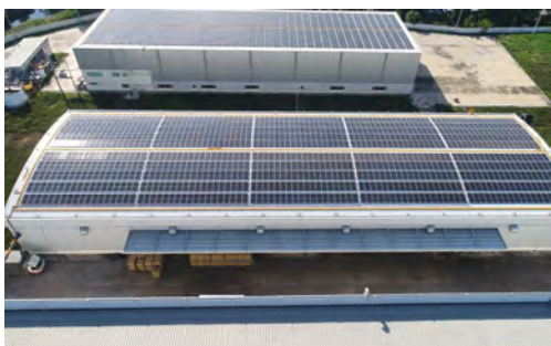
NISSIN FOODS (THAILAND) CO.,LTD.の工場で設置されている太陽光パネル
