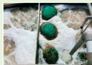
エアレーション槽
